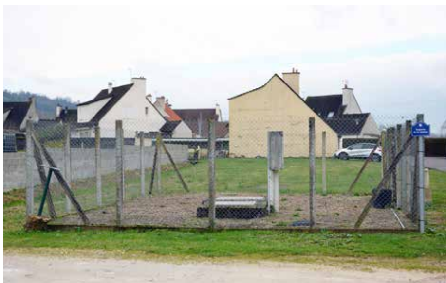
Station de relevage du Gour Neuf
